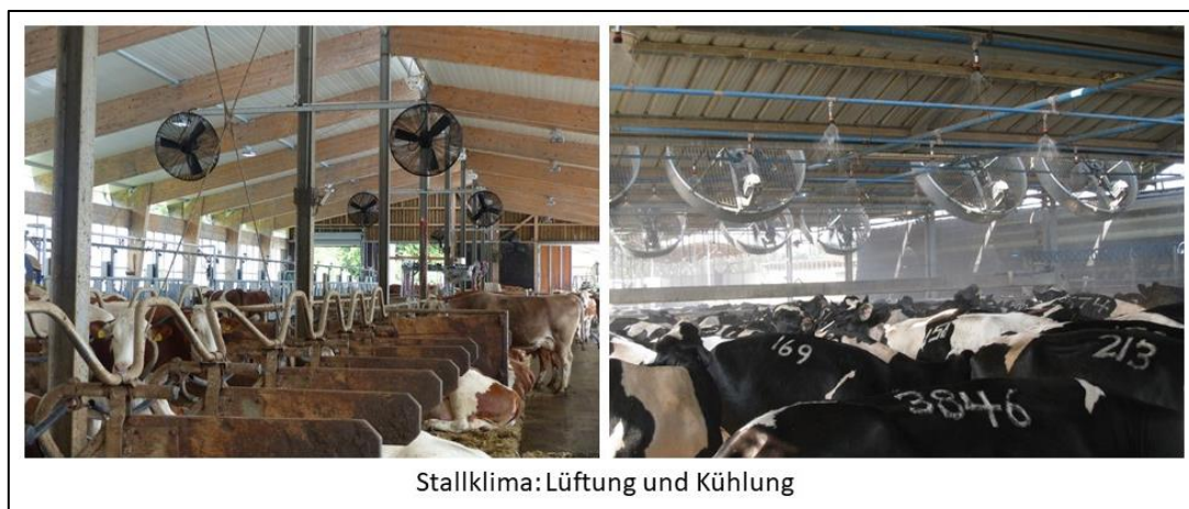
Abbildung 39: Axialventilatoren mit und ohne Wasserkühlung zur Reduzierung des Hitzestressrisikos (Bildquelle: LAZBW).
